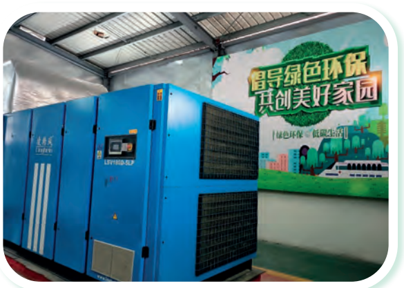
引進變頻螺桿機隔離供氣節能改造
