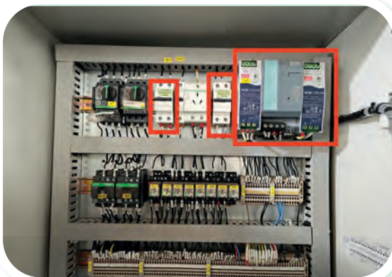
圖三：供熱快關閥、LV閥油站控制櫃一路電源改兩路
